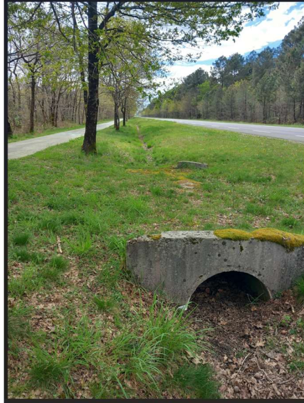
Fossé de la RD1250
